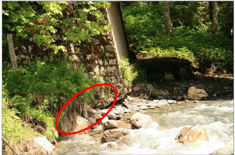
Fig. 1. Etat initial : incision sous la pile du pont en rive droite.
